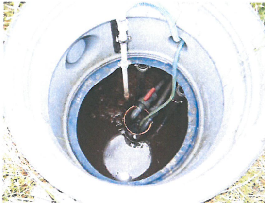
Belebungs 1 mit Filterrohr und Dosierpumpe
