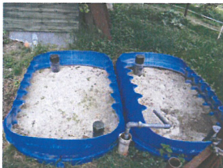
Bodenfilter zur Schlamm entwässerung mit Filtratrücklauf zur Belebungs 1
