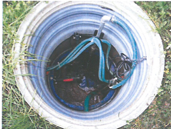
Belebungs 2 mit Rückförderpumpe und Klarwasserpumpe
